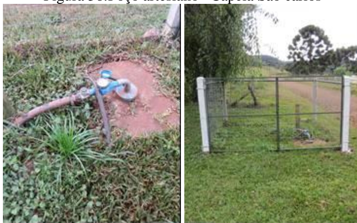
Figura 56: Poço artesiano – Capela São carlos
