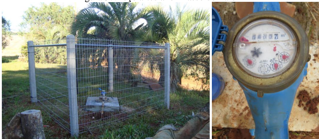
Figura 57: Poço artesiano – Passo do Paiol
