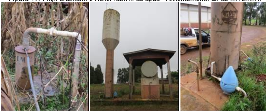
Figura 49: Poço artesiano e Reservatório de água– Assentamento 25 de novembro
