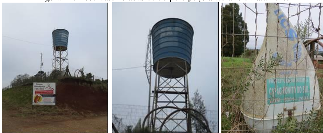
Figura 42: Reservatório abastecido pelo poço artesiano e tratamento
