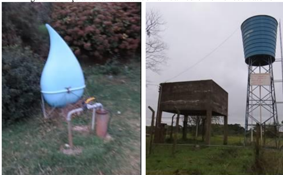
Figura 40: Poço artesiano instalado na Rua Pedro Boff e reservatório
