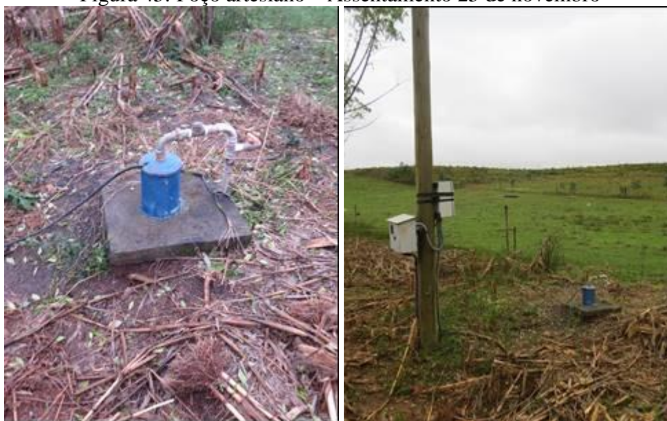
Figura 45: Poço artesiano – Assentamento 25 de novembro
