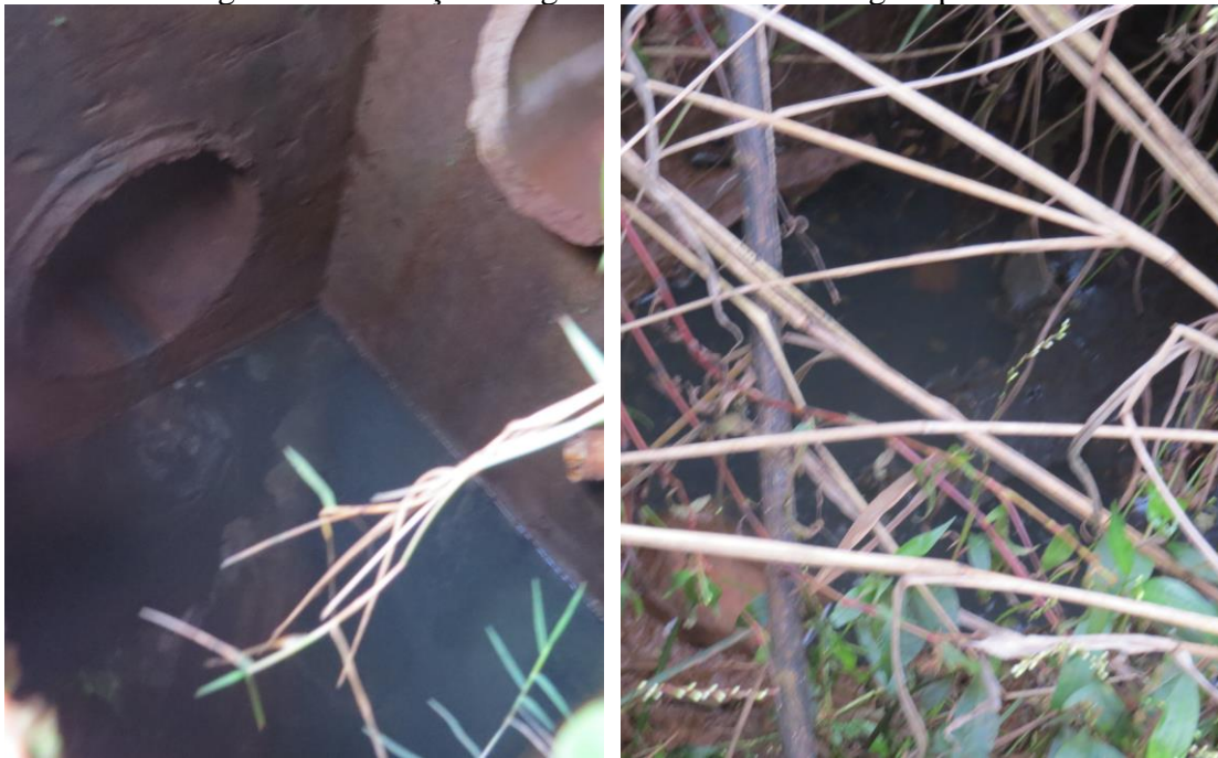
Figura 72: Presença de esgoto em redes de drenagem pluvial
