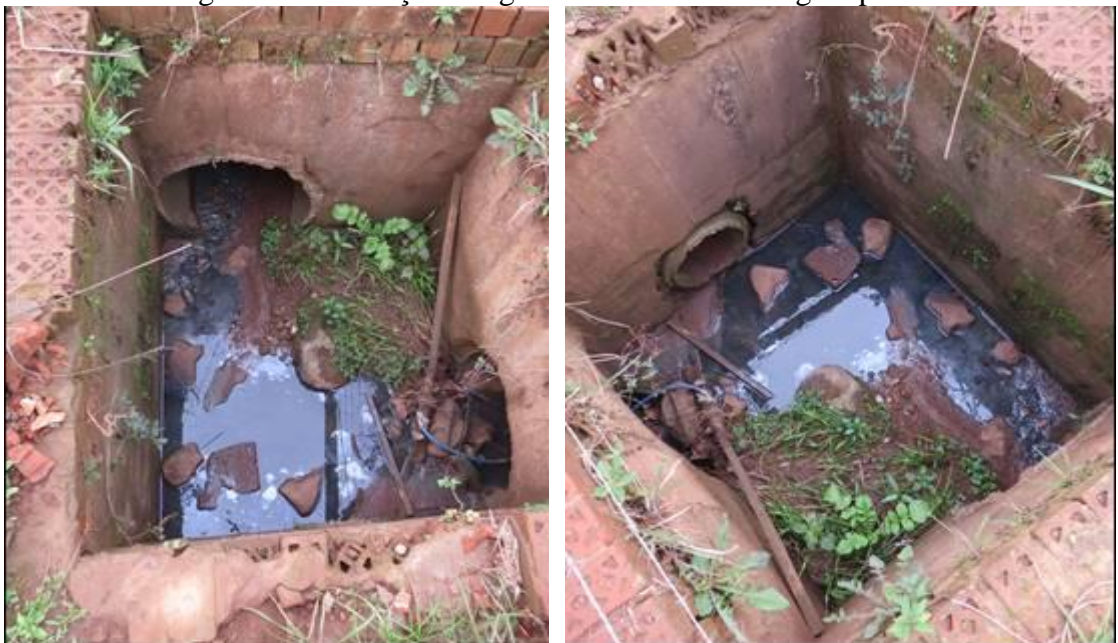
Figura 71: Presença de esgoto em redes de drenagem pluvial
