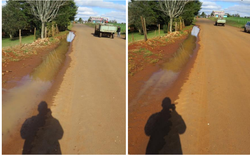
Figura 121: Ponto de acúmulo de água na área urbana do município
