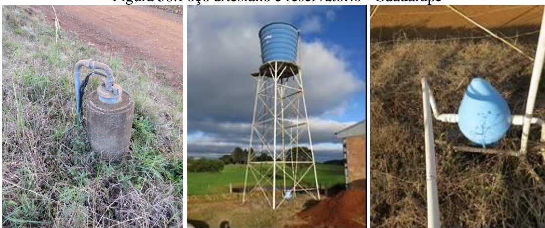
Figura 58:Poço artesiano e reservatório– Guadalupe
