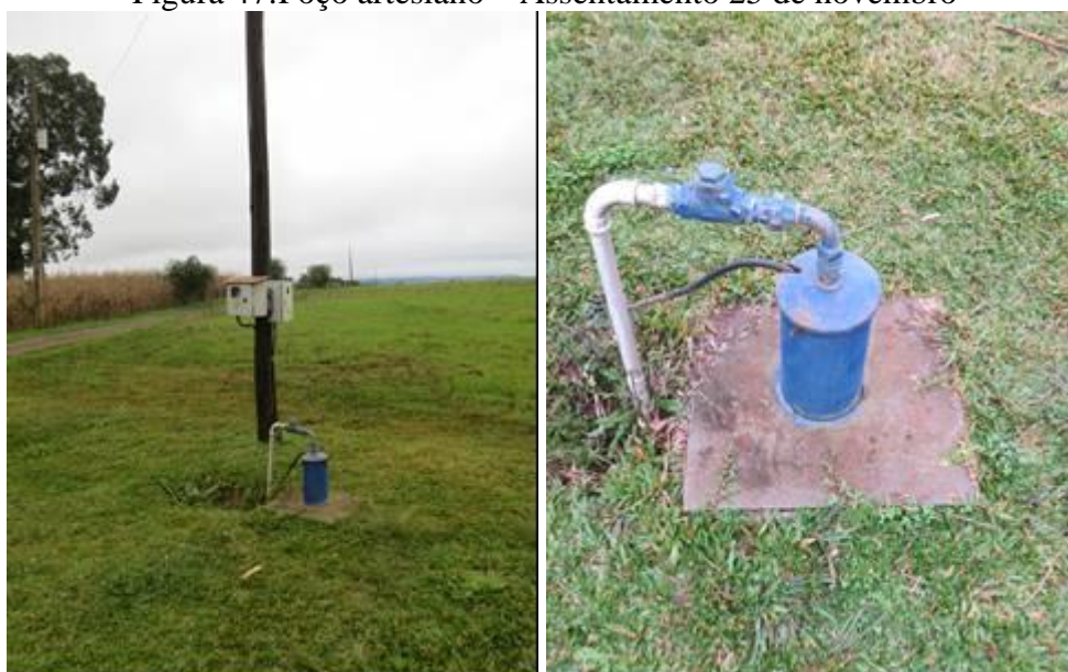
Figura 47: Poço artesiano – Assentamento 25 de novembro
