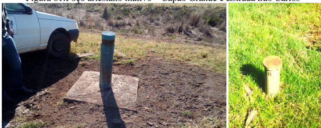
Figura 61: Poço artesiano inativo – Capão Grande e Estrada São Carlos
